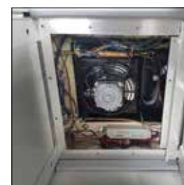
A5. Vano condensatore
