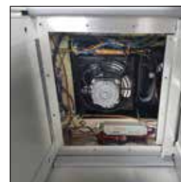
A5. Vano condensatore
