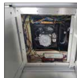
A5. Compartimento del condensador
